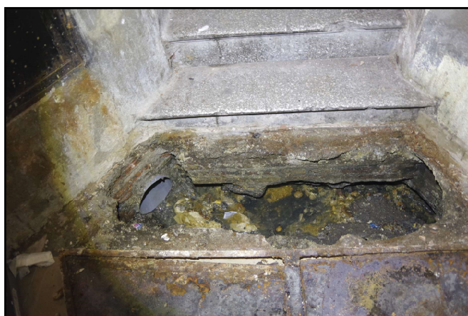
Aigües residuals a l'inici de la rasa, en el contacte amb el baixant dels pisos superiors
